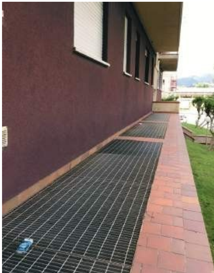
GRIGLIE DI AERAZIONE DELL'AUTORIMESSA
